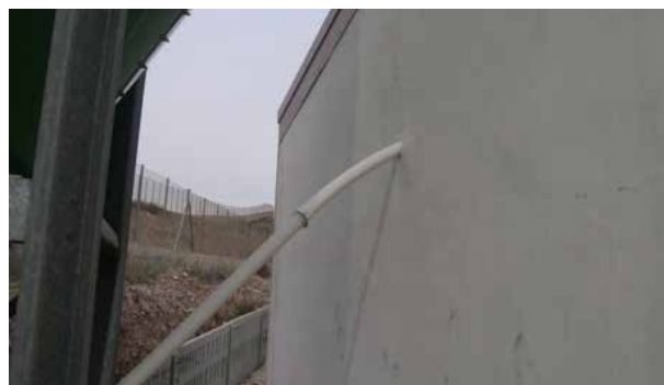
Figura 2: Los orificios alrededor de cualquier conducción que atraviere los muros de la nave deben quedar perfectamente sellados, para evitar la entrada de roedores.
